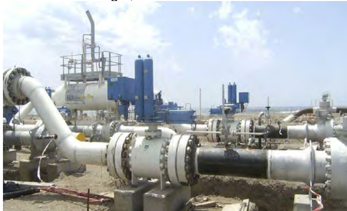
Calderas de la terminal de recepción del gasoducto Medgaz que une España y Argelia en la playa de El Perdigo, Almería EXPANSION
