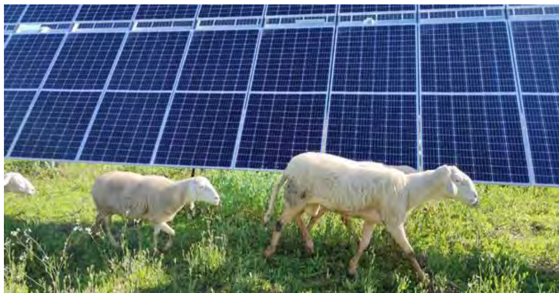
Plantas fotovoltaicas de Endesa en Carmona, en una imagen de archivo.
