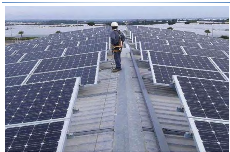
Instalación fotovoltaica de Alter Enersun, en Lepe (Huelva). Jose Luis Rodriguez Planas EXPANSION
