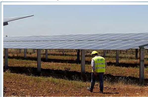
Un trabajador, en la planta fotovoltaica de las Corchas, en Carmona (Sevilla).
