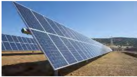
Planta fotovoltaica Picón, en Ciudad Real, de Naturgy.
