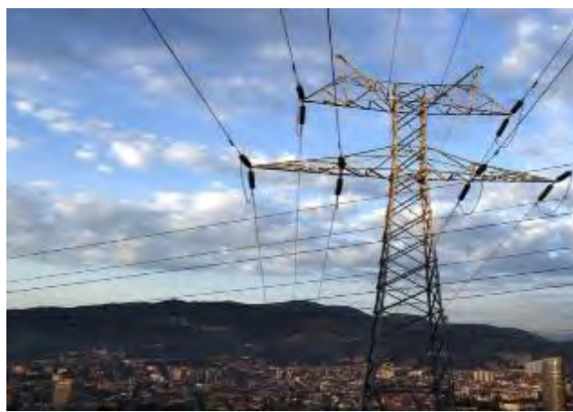
Una torre de transporte de energía perteneciente a red eléctrica, con la ciudad de Bilbao al fondo
